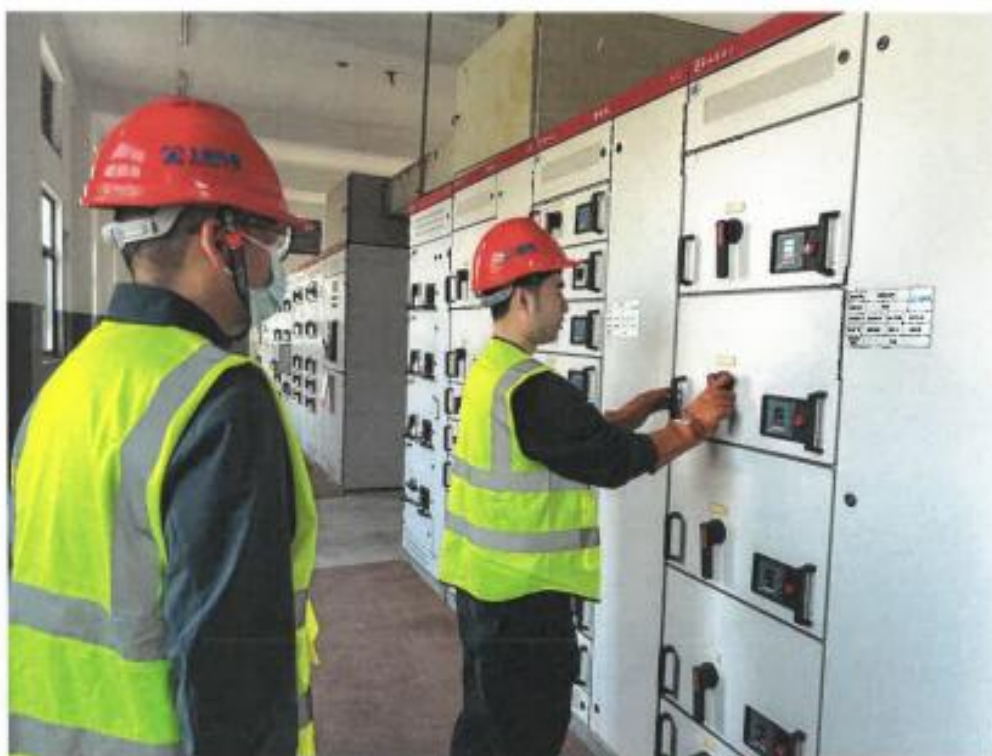
台风天配电房跳闸，值班人员到现场查看情况（演练）
